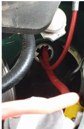
Detalle del paso al habitáculo del cable positivo
